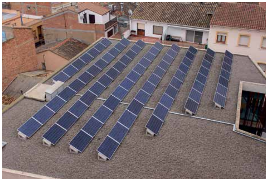
El Ayuntamiento seguirá invirtiendo en placas fotovoltaicas
